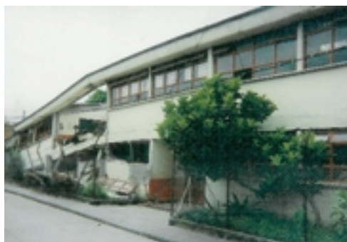
Un collège d'Armenia (Colombie), après le séisme de 1999. La rupture des poteaux de rez-de-chaussée a entraîné la chute du mur de façade d'une classe et de son toit. Photo PM Sarant
